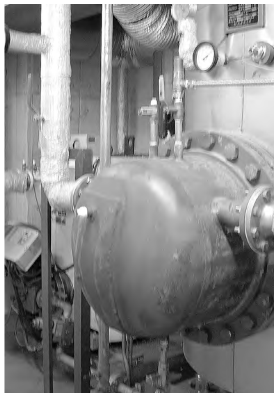
ボイラー設備
