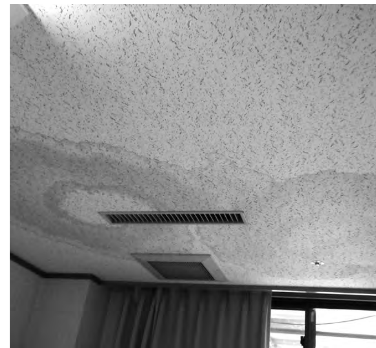
雨漏りによる天井のしみ
