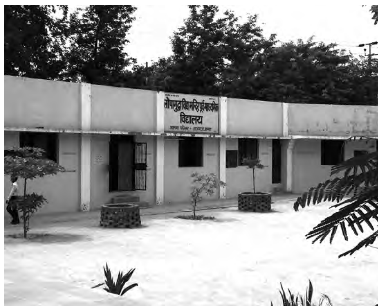
壁面は塗装がはがれるなどしています
