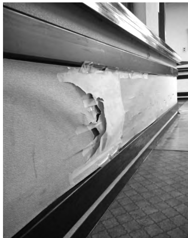
壁紙クロスの剥がれや破れ
